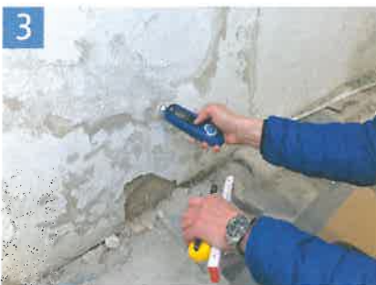
3 Ein klares Anzeichen für Feuchteschäden: Putz platzt ab und Salzausblühungen treten auf.
