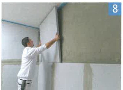
8 Die Klimaplatten erhöhen die Wandoberflächentemperatur und schützen vor Schimmelbefall.
