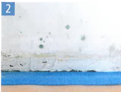
2 Im Home-Office zeigten sich in den Ecken der Außenwand plötzlich Stockflecken.
